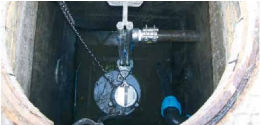
Een put met een waterpomp.
